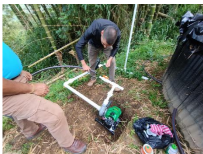
Figura 3. Instalación motobomba. Municipio Líbano Tolima
