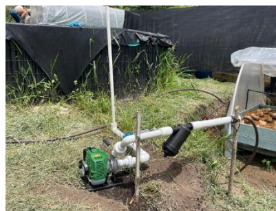
Figura 4. Instalación motobomba. Municipio Líbano Tolima
